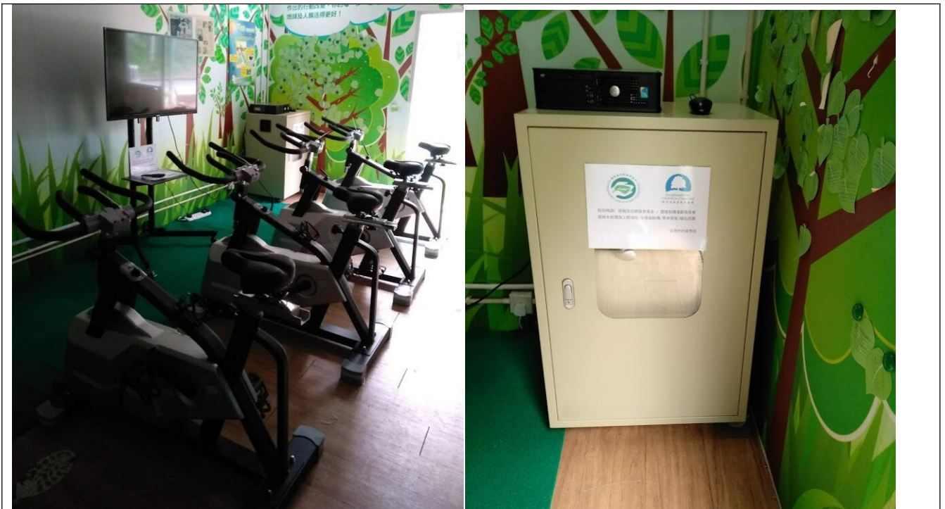
單車發電系統安裝位置相片
